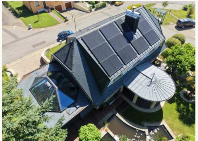
Photovoltaik um Daach
